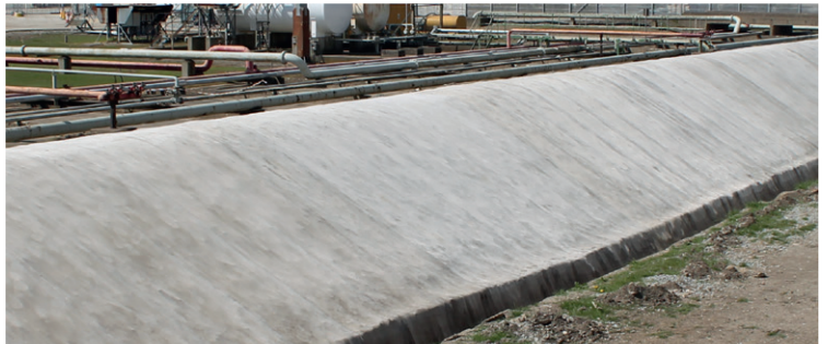
CC fijado a canal de drenaje de hormigón
